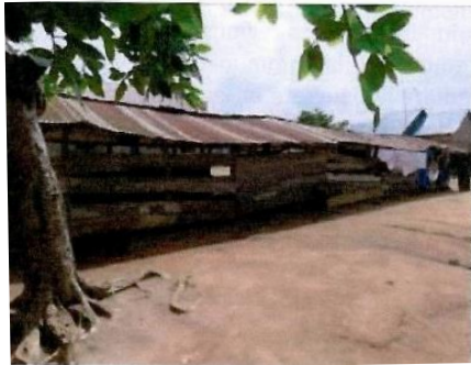
Bestehendes, baufälliges Gebäude
